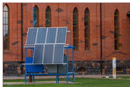
Фото 2. Установка альтернативной энергетики
