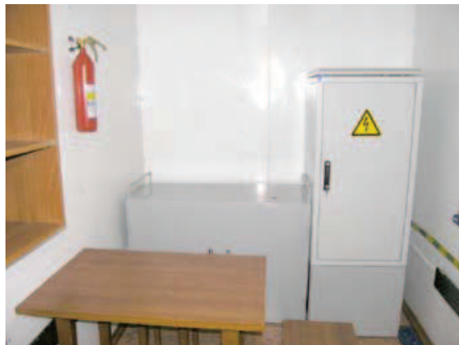
Фото 8. Комплекс модульного оборудования, установленный в блок-контейнере (внутри)
