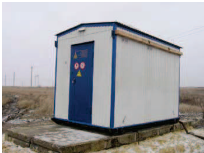
Фото 7. Комплекс модульного оборудования, установленный в блок-контейнере
