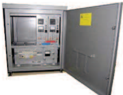
Фото 6. Станция катодной защиты НГК-ИПКЗ
